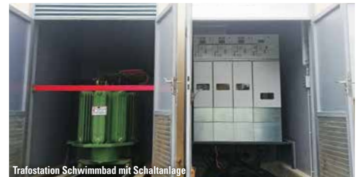
Trafostation Schwimmbad mit Schaltanlage
